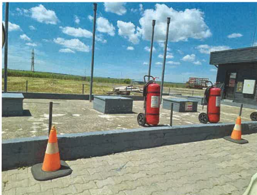
FIGURA 6. FOTOGRAFIE A INSTALAȚIILOR EXISTENTE: CĂMINE TEHNOLOGICE, AERISIRI ȘI MIJLOACE MOBILE DE INTERVENȚIE. CIRCUITELE SE IDENTIFICĂ INDIVIDUAL ÎNAINTE DE SCOATEREA DIN SERVICIU.
