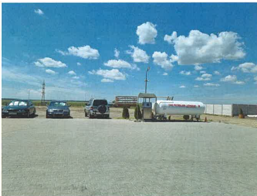
FIGURA 5. FOTOGRAFIE A INSTALAȚIEI EXISTENTE DE GAZ PETROLIER LICHEFIAT ȘI A PLATFORMEI DE DISTRIBUȚIE. CAPACITATEA NOMINALĂ DE 5.000 L ESTE CONFIRMATĂ DE DOCUMENTAȚIA INSEMEX ȘI DE ATESTATUL VAMAL.
